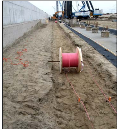
Installatie van de ontgrondingsdetectie
